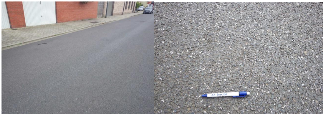
Figuur 5-9 Afgesleten bitumenfilm en zichtbare granulaten in het proefvak Microville [B. Duerinckx – 15]
