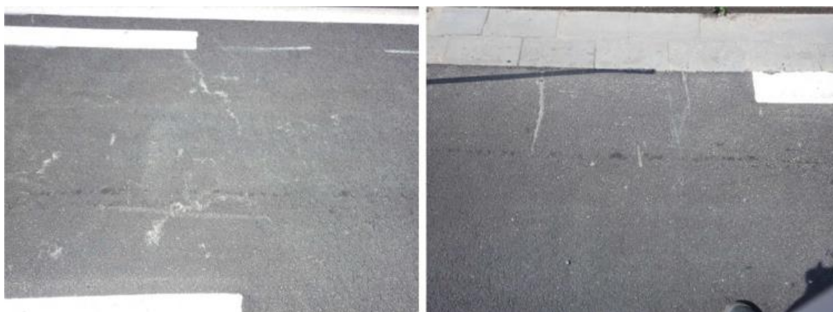
Figuur 5-7 Schade ter hoogte van het fietspad in het proefvak Decipave [B. Duerinckx – 15]
