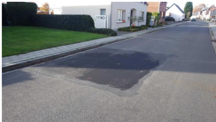
Figuur 5-11 Plaatselijke herstelling t.g.v. een verzakking in het proefvak SMA-C2 [B. Duerinckx – 15]
