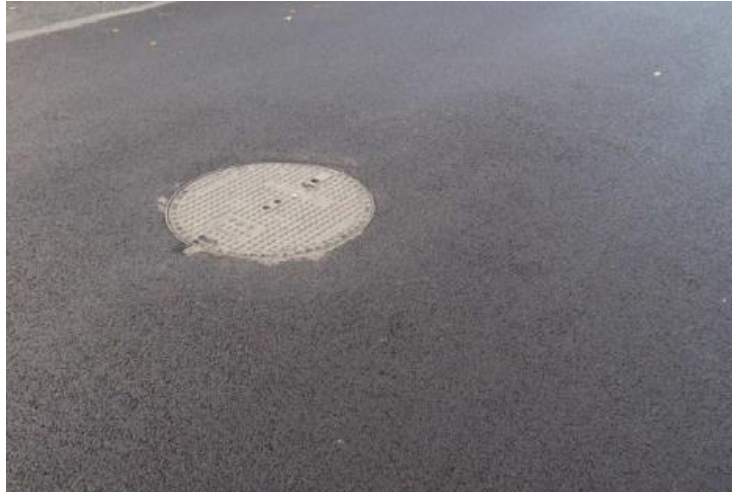
Figuur 5-15 Open aspect van de toplaag rond een riooldeksel in het proefvak SMA-D [B. Duerinckx – 15]
