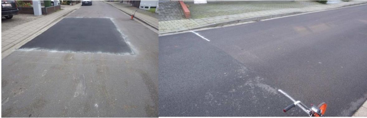
Figuur 5-13 (links) plaatselijke herstelling in proefvak Micropave – (rechts) overgangснаad met rafeling [B. Duerinckx – 15]
