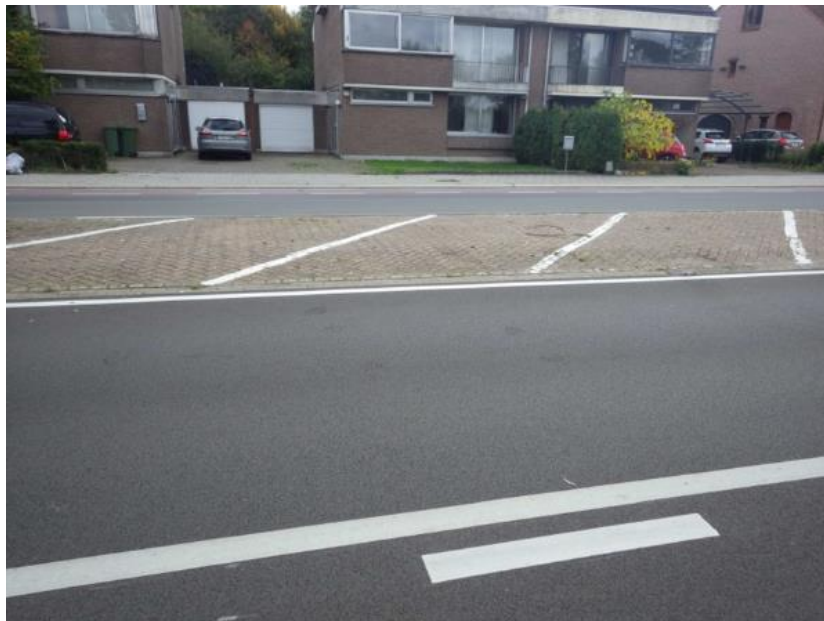
Figuur 5-3 Lichte rafeling (wringplekken) op het proefvak Micropave [B. Duerinckx – 15]
