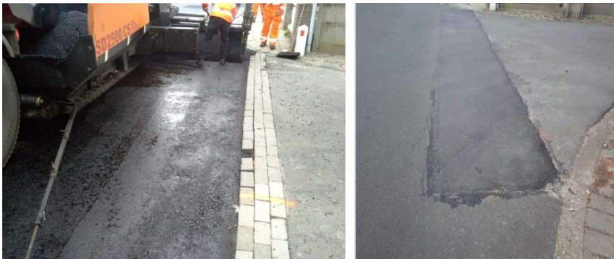
Figuur 5-14 Aansluiting met het Berendrechts voetpad in het proefvak Decipave (links) bij aanleg – (rechts) plaatselijke herstelling [B. Duerinckx – 15]
