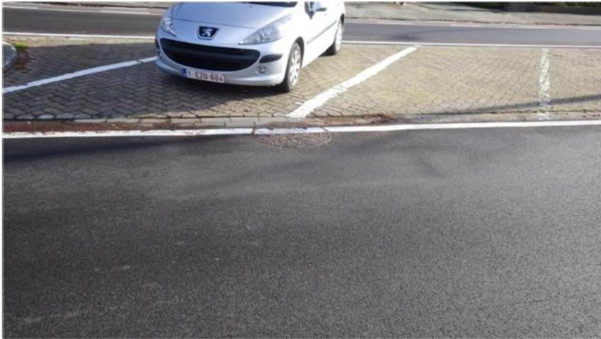
Figuur 5-4 Lichte verzakking de overgangszone tussen Micropave en Nobelpave [B. Duerinckx – 15]
